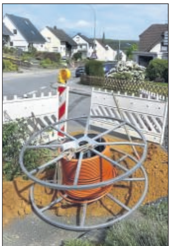
Wie hier in Wickede werden viele Kilometer Glasfaserkabel im Kreis Soest verlegt. • Foto: hütt
